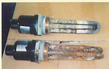
ウォータヒータ外観状況
